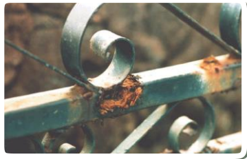
Un metal se oxida (Corrosión)
